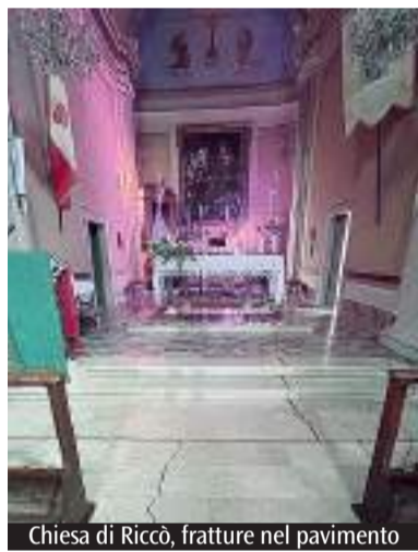
Chiesa di Riccò, fratture nel pavimento
